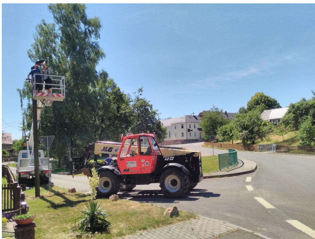
Foto: Andreas Rättsch, 2019, LED-Straßenbeleuchtung an der Kreisstraße in Rathendorf
